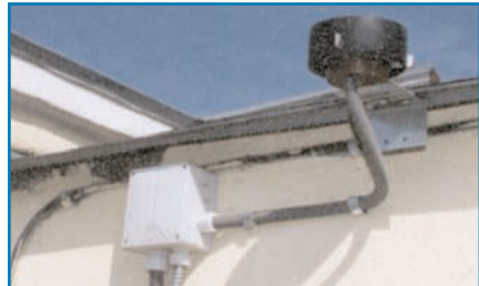
Рис. 25 Пример установки датчика осадков и распределительной коробки (хорошо виден Г-образный кронштейн)
