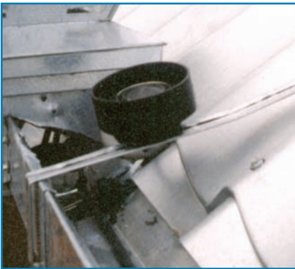
Рис. 23 Пример установки датчика осадков на укрепленном лотке
